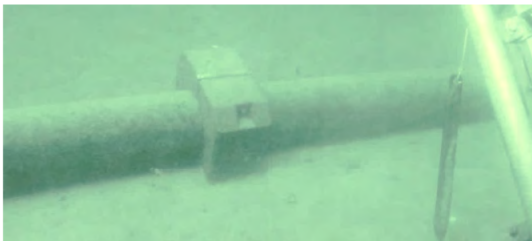
Abbildung 49: Identifizierte Druckleitung am Seegrund (Lehnberg, 2012).
